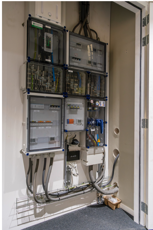
Overzicht van de meterkast met de slimme tussenmeters
